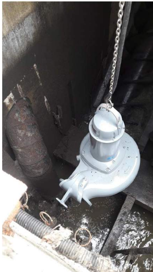
pompe de secours
