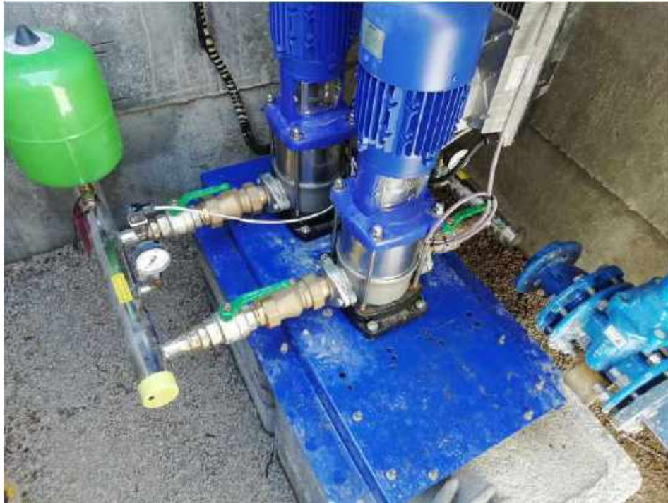
Surpresseur rue du camping Fesches le Châtel
