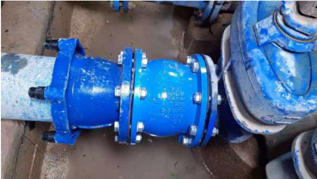
Clapet réservoir des 3 bornes
