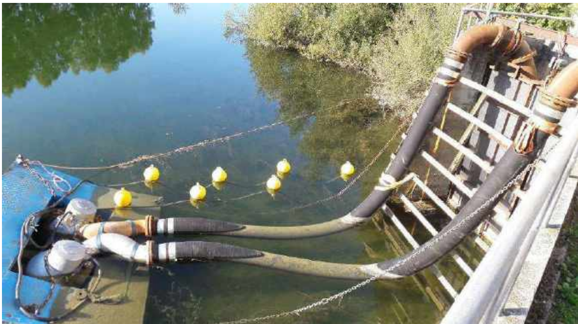
Pompe de secours dans le Doubs en septembre 2018 – Captage de Mathay
